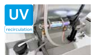
Tratamiento de agua mediante UV
