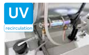
Tratamiento de agua mediante UV
